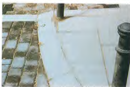
Particolare del bordo del cordolo sugli attraversamenti pedonali
