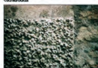
RIVESTIMENTI STORICI RIPRODOTTI IN MODO NON CORRETTO
