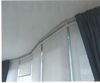
Particolari dei sistemi di funzionamento dei tendaggi
