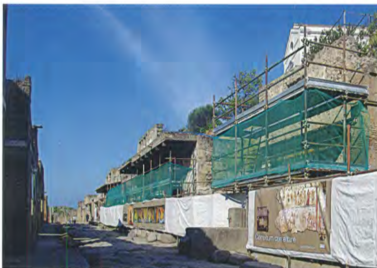
Pompei, via dell'Abbondanza (Regio IX, Insulae 7 e 11), vista complessiva del cantiere di restauro, sperimentazione e formazione che ha visto il coinvolgimento di stagisti e studenti di diverse facoltà e scuole di formazione
