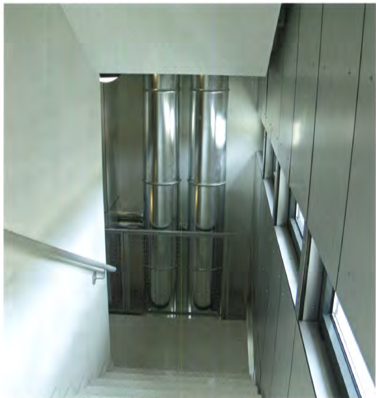
Vano scala. Condotti di immissione ed emissione dell'impianto di ventilazione controllata
