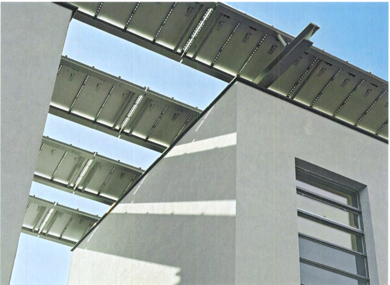
Particolare del "tetto energetico", elemento di collegamento tra le singole unità abitative
